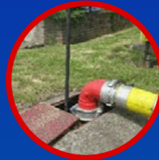
Bouche Incendie (BI)
