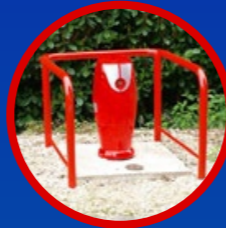
Poteau Incendie (PI)
